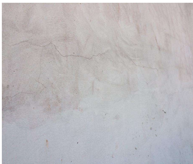
Figura 4 - Retração devido ao sarrafeamento precoce, ocorrida na edificação 2. Fonte: Próprio autor (2019).
